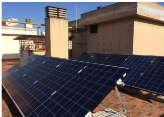
Figura 4. Instalación fotovoltaica con almacenamiento por Gas Natural Fenosa y gestión inteligente por IREC, socios de GrowSmarter.
