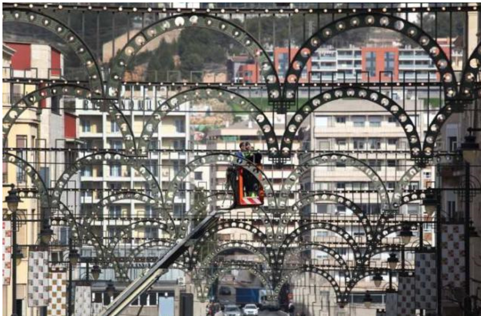
Figura 1. Ejemplo de instalación de luminarias existentes en Alcoi con la enramada en la plaza Mayor y calles aledañas.
